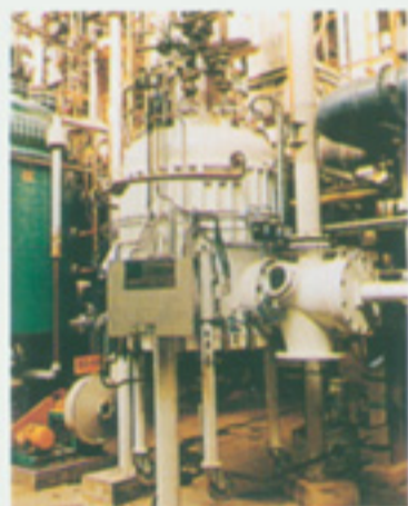
在制药业化学过滤干燥机上的应用
